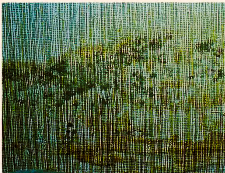
Missfärgad tapet. Fukt i material ger grogrund för mögel.
