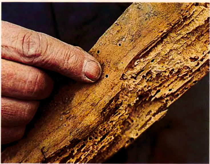
Rötskadat trä med angrepp av envis trägnagare.
